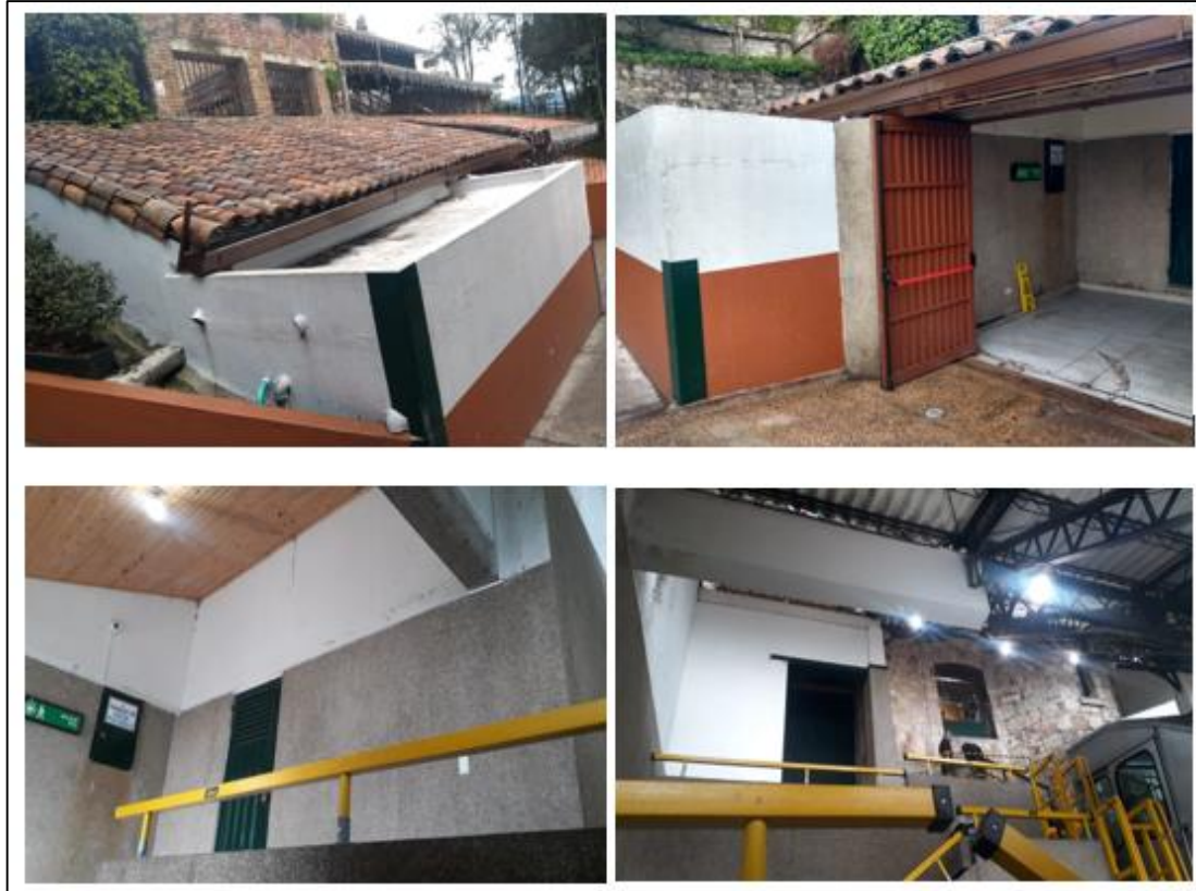
Figura 16. Tanque de almacenamiento de agua, sin sistema alarma.
