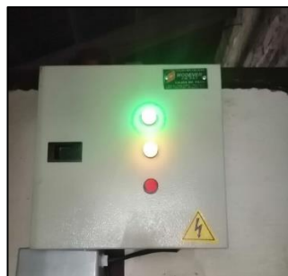
Figura 22. Indicación por los testigos del sistema de Alarma de Nivel
