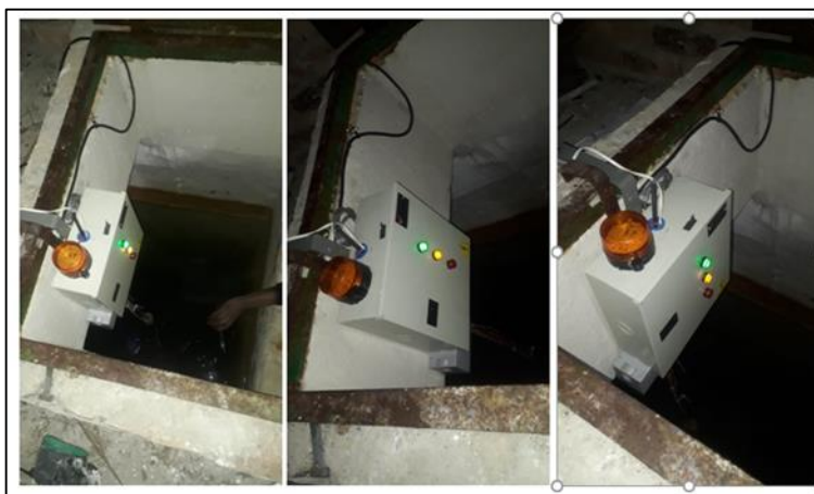
Figura 20. Sistema de alarma en funcionamiento
