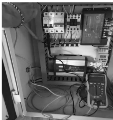
Figura 6: Lectura de corriente generada por los paneles
