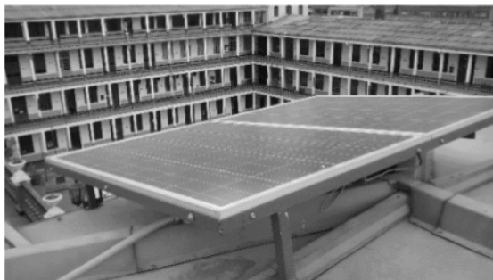
Figura 2: Paneles del sistema solar fotovoltaico
