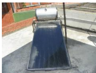
Figura 1. Calentador solar de agua de tubos y placa metálica, para las duchas del gimnasio de la Facultad Tecnológica de la Universidad Distrital FJC.
